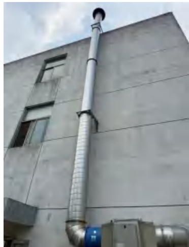
DA012 废气处理设施及排气筒
