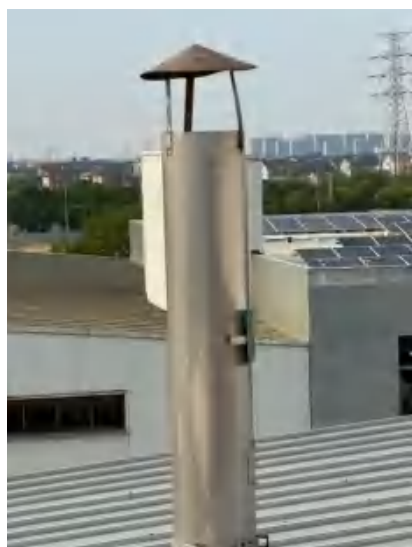
DA009 废气处理设施及排气筒
