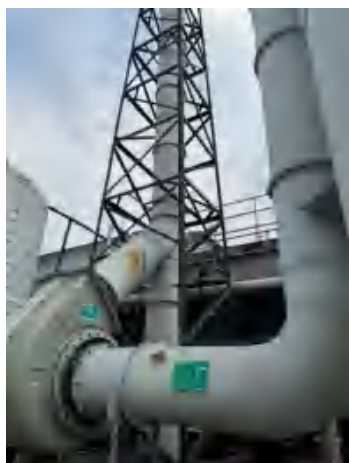
DA003 废气处理设施及排气筒
