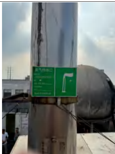
DA006 废气处理设施及排气筒
