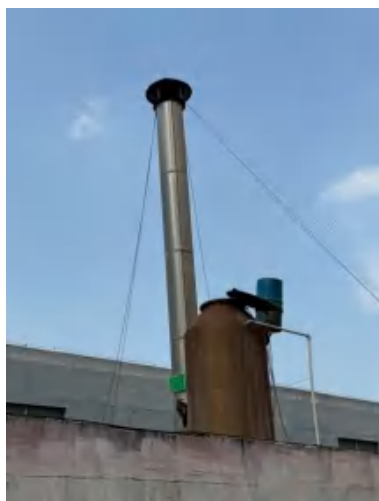
DA005 废气处理设施及排气筒
