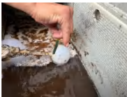
碱喷淋塔碱性液体
