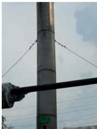
DA002 废气处理设施及排气筒
