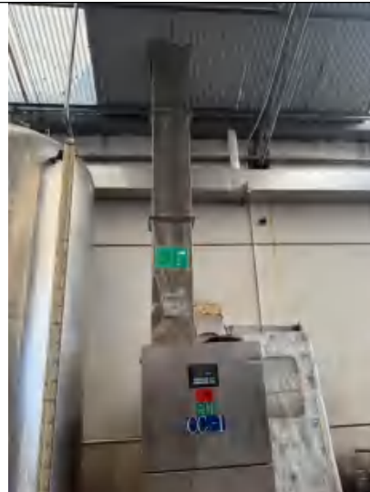
DA010 废气处理设施及排气筒
