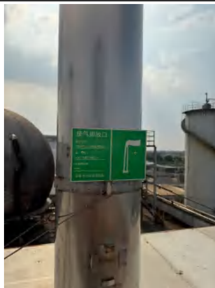
DA008 废气处理设施及排气筒
