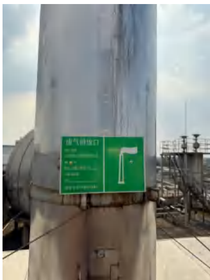
DA007 废气处理设施及排气筒
