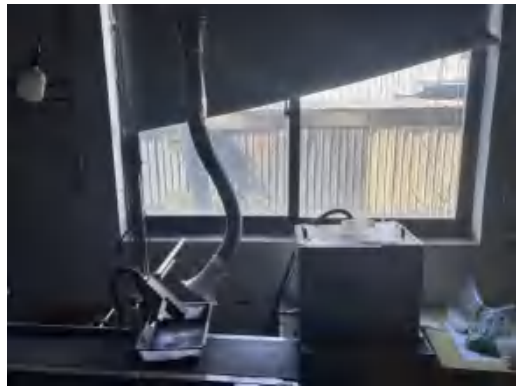
印字废气集气装置
