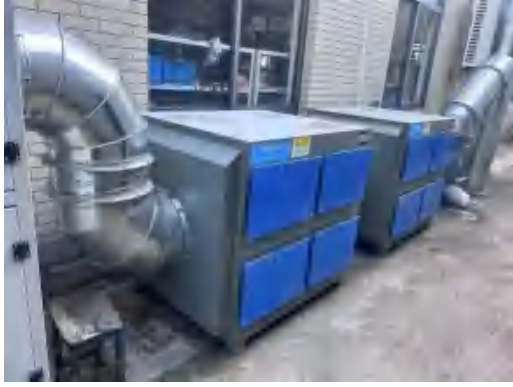
烟尘净化装置+活性炭吸附设施
