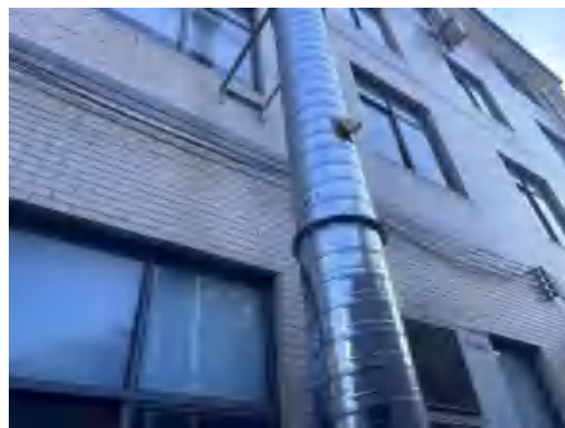
废气排气筒出口
