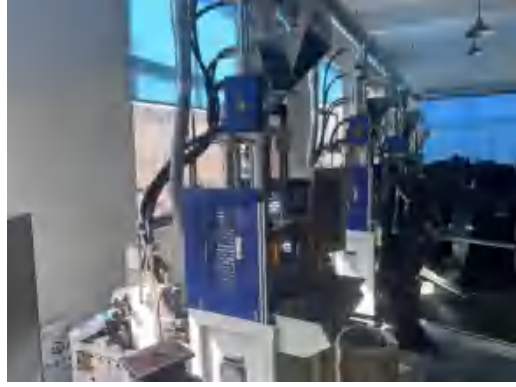
注塑成型废气集气装置
