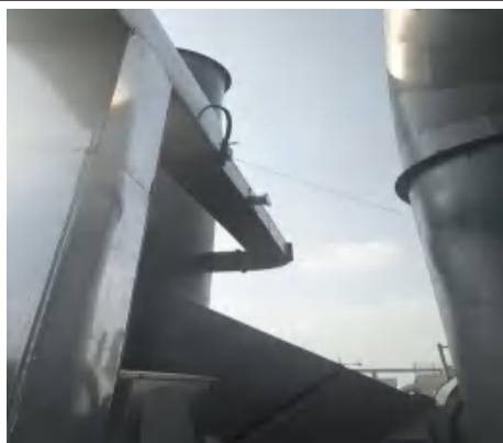
脱附+催化燃烧排气筒出口
