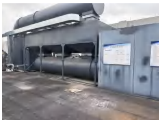
活性炭吸附-脱附+催化燃烧设施
