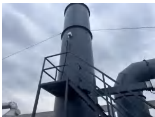
活性炭吸附废气排气筒出口
