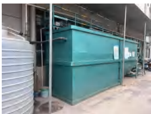
浙江永途新能源科技有限公司污水站
