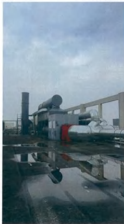
涂装废气处理设施
